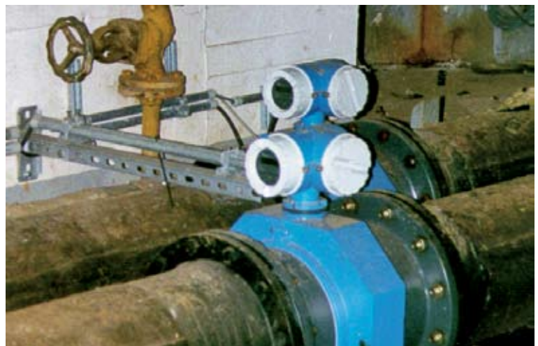
El medidor de flujo electromagnético Promag registra los volúmenes de agua de enfriamiento
