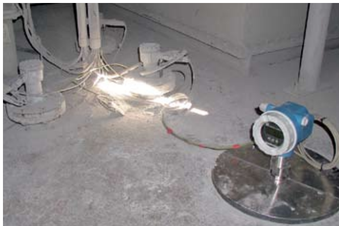
El Soliphant mide los límites máximos en el silo de cal viva, Levelflex monitorea el nivel de cal viva en el silo
