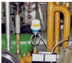
El termoelemento TSC monitorea la temperatura en las líneas de aceite que van a la caldera
