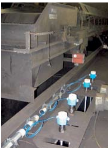
Detección de mínimo/máximo de Solicap en búnker de carbón
